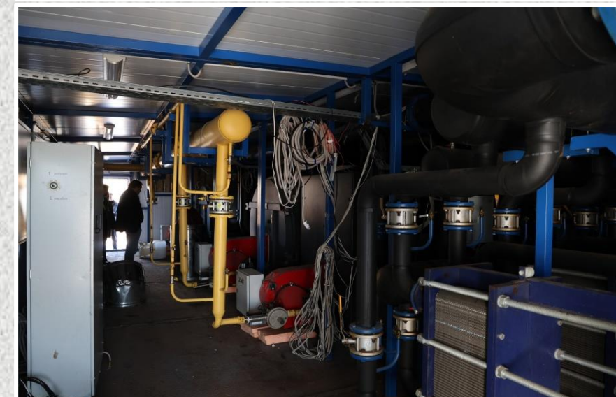
ООО «УК «ТЕПЛОКОМПЛЕКС» Водогрейная котельная (ул. Революционная) (мощность 7,5 МВт)
